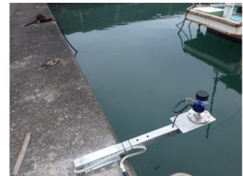
漁港に設置した水位計
